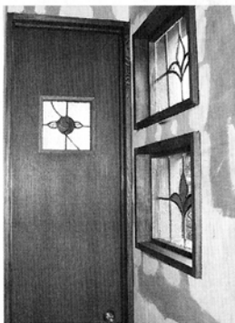
使用塗料(内・外装用) リオスモカラー、ウッドステインプロテクター(人体やペットに優しい)、さらに木質塗膜による美しいステイン仕上げができることから選択 ※写真は施工中
